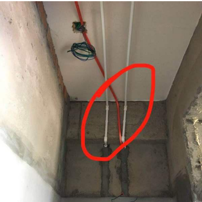
▲错误案例：水电同槽，这个水电师傅真会省事
