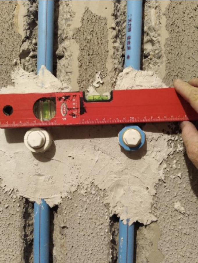
▲冷热出水口不水平
