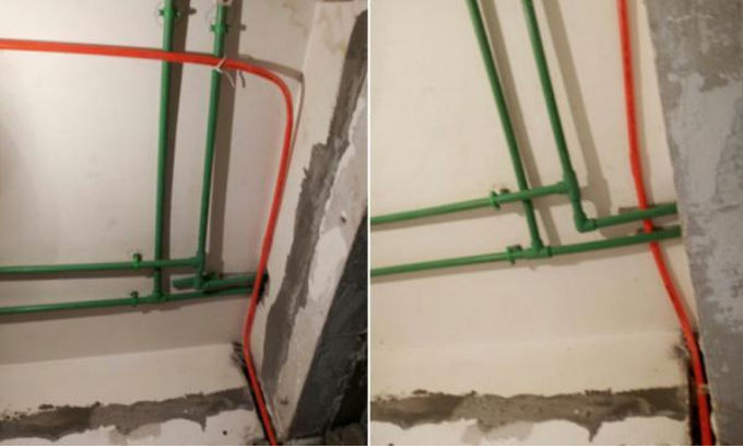
▲一个用户家里水管铺设刚开始不符合电上水下原则，后面进行了整改。（左：电下水上；右：电上水下）
