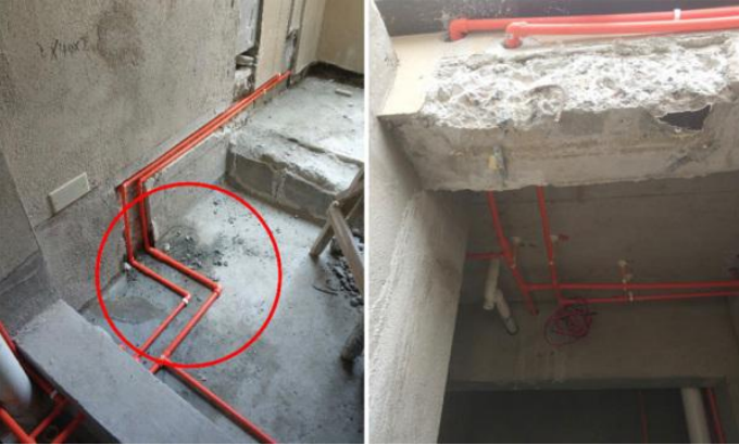
▲一个用户家里卫生间水管走地，还在楼板开孔，后期防水很难做，后来改走顶面。（左：走地；右：走顶）
